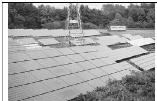
写真) 山梨県北杜市の太陽光発電所
